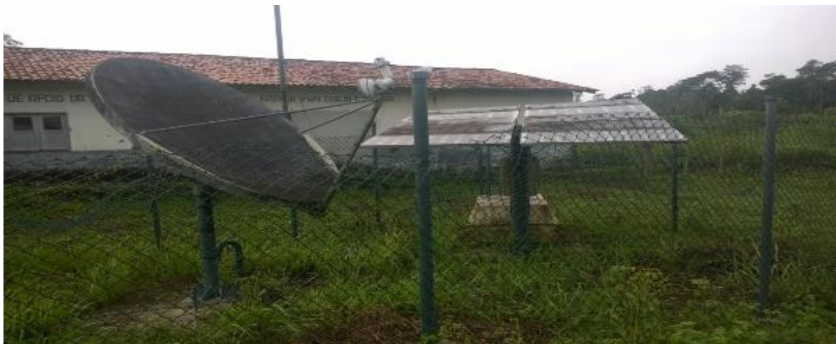
Figura 4: Painéis Solares Sucateados Sem Funcionamento.
