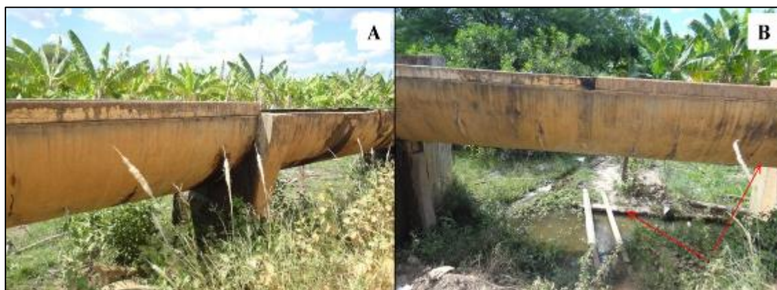
Figura 4 – Acéguas do Projeto Gorutuba: (A) acéquia com vazamento em sua coluna de concreto e; (B) acéquia com poça de água resultante de vazamentos em sua estrutura. Fonte: fotos tiradas em campo, janeiro de 2017.
