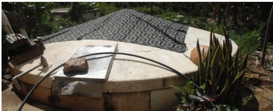
Figura 1 – Cisterna de placas na comunidade de Baixio (Quiterianópolis)
